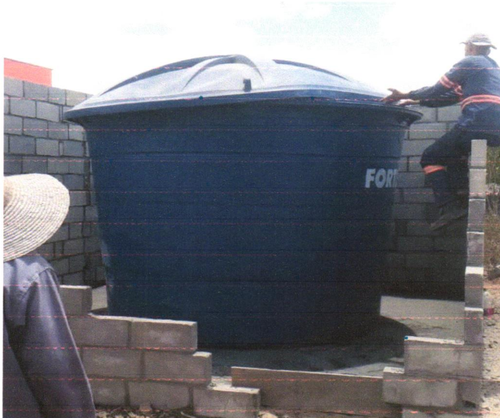
Foto 05 - RESERVATÓRIO DE POLIETILENO 10.000 LITROS
