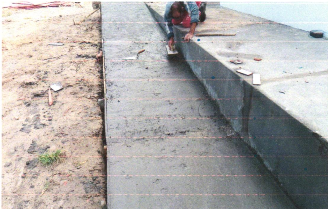
Foto 13 - Rampa padrão para acesso de deficientes a passeio público, em concreto simples F_{ck}=25MPa , desempolada, pintada em novacor, 02 demãos e piso tátil de alerta/direcional.
